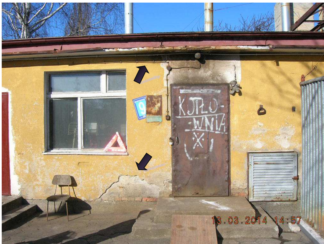
Widoczne ubytki w tynku i obróbce blacharskiej gzymsu.
