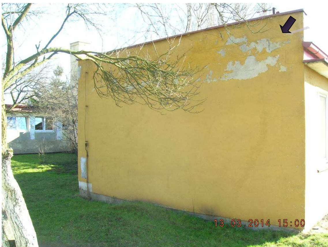
Przykład spękanej attyki - do przemurowania
