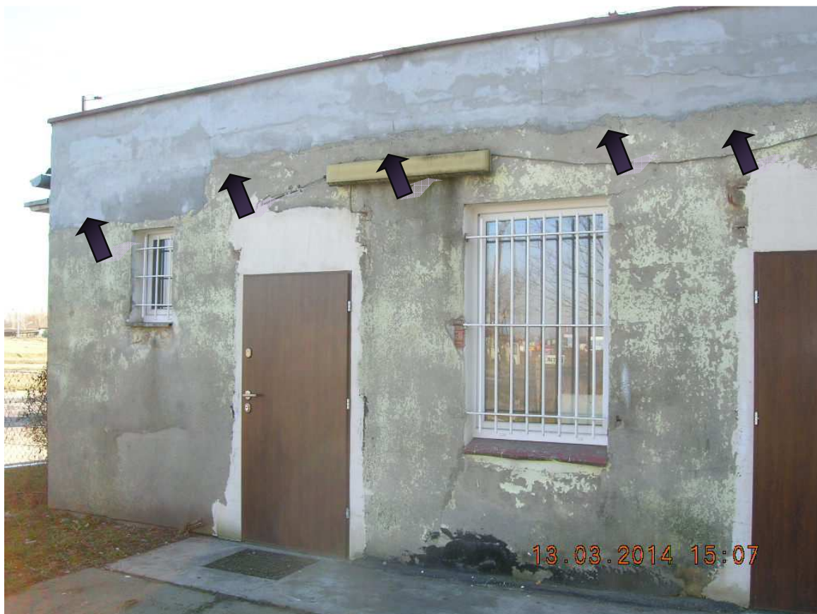
Uszkodzona attyka zabezpieczona zaprawą cementową wg zaleceń poprzedniego opracowania.
