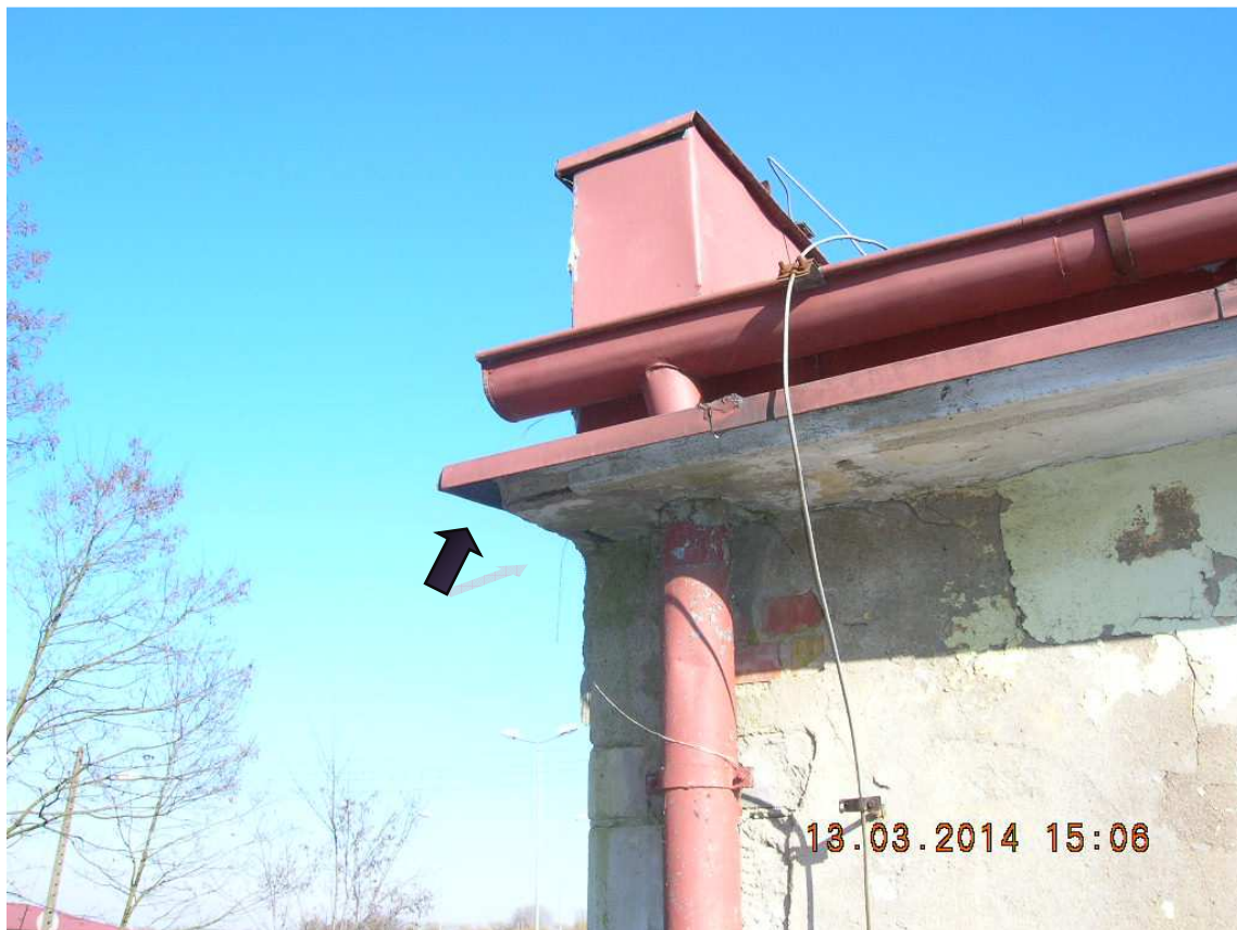
Ubytek otuliny w żelbetowym gzymsie.
