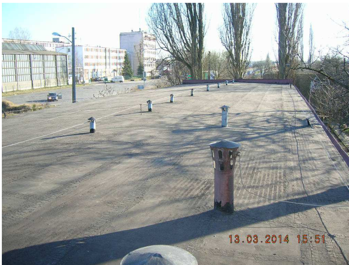
Widoczne ślady zużycia pokrycia dachowego oraz skorodowane i uszkodzone wywiewki – do wymiany
