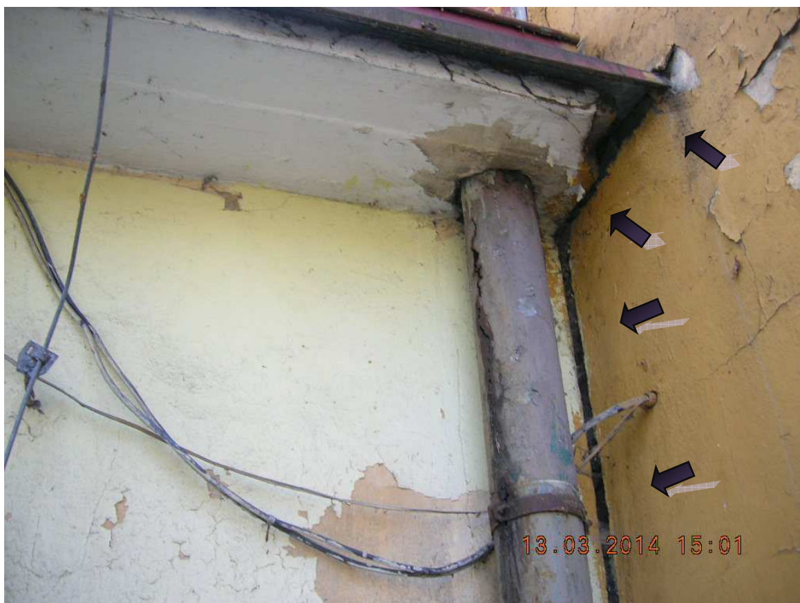
Szczelina powstała na styku budynku głównego z częścią rozbudowaną i skorodowana rura spustowa
