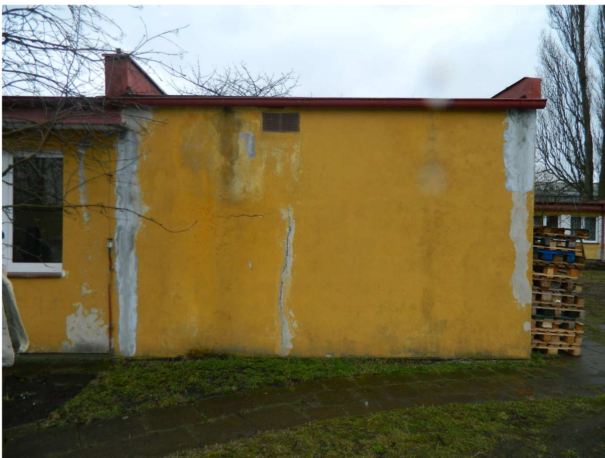
Rysy na elewacji zewnętrznej, część zabezpieczona zaprawą.
