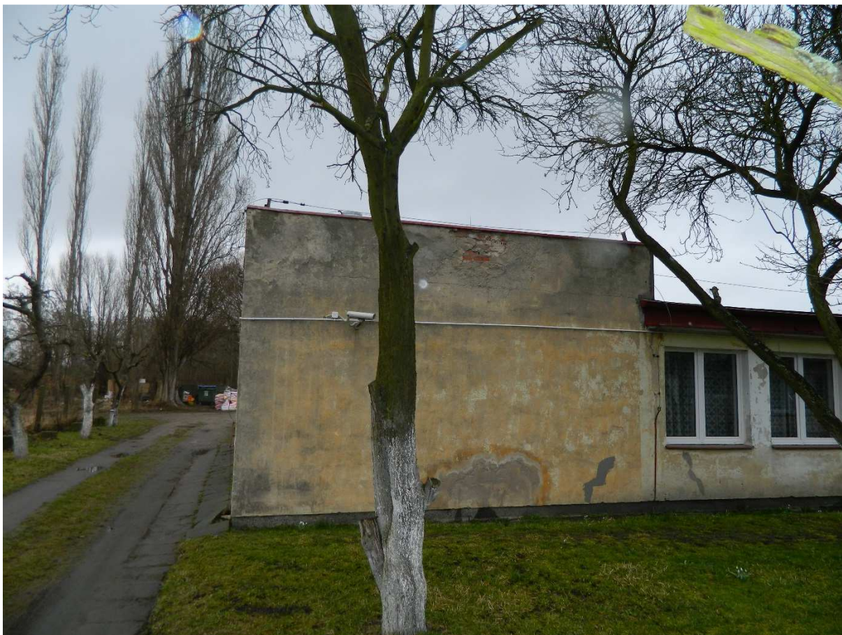
Uszkodzenie attyki, rysy w konstrukcji ściany i ubytki w tynkach uzupełnione zaprawą
