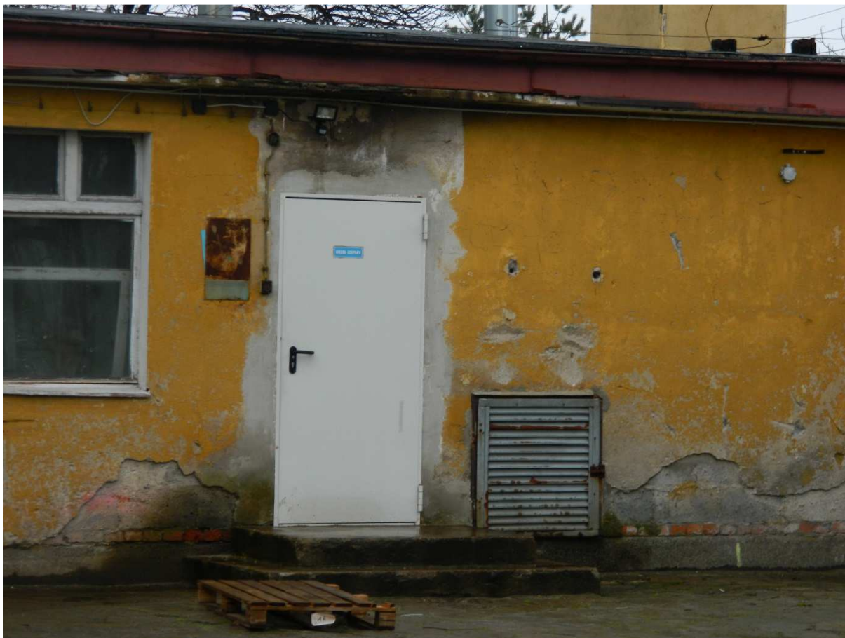
Ubytki w tynkach i skorodowania opierzeni gzymsów
