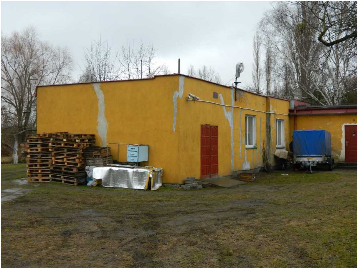
Widoczne zabezpieczone zaprawą rysy na elewacji zewnętrznej
