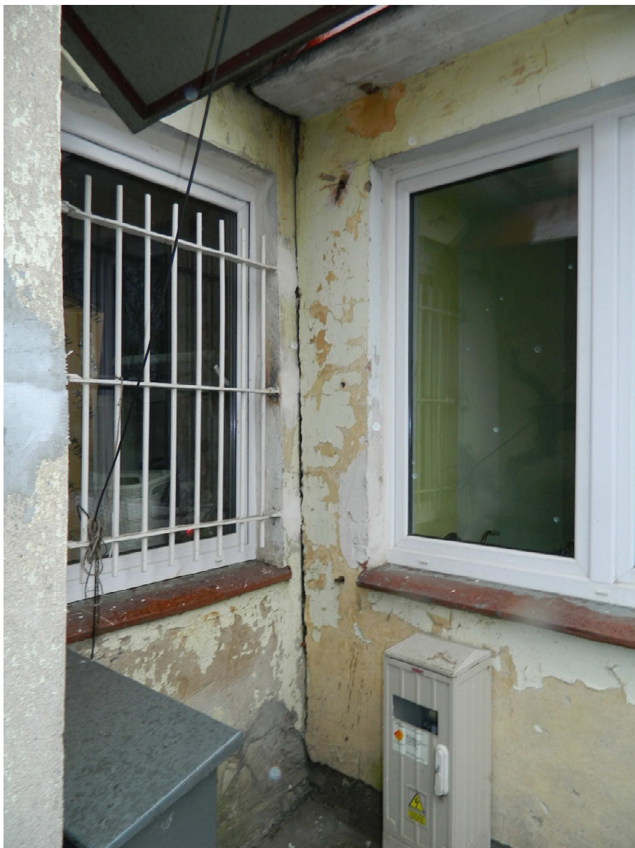
Szczelina na styku części starej z nowszą
