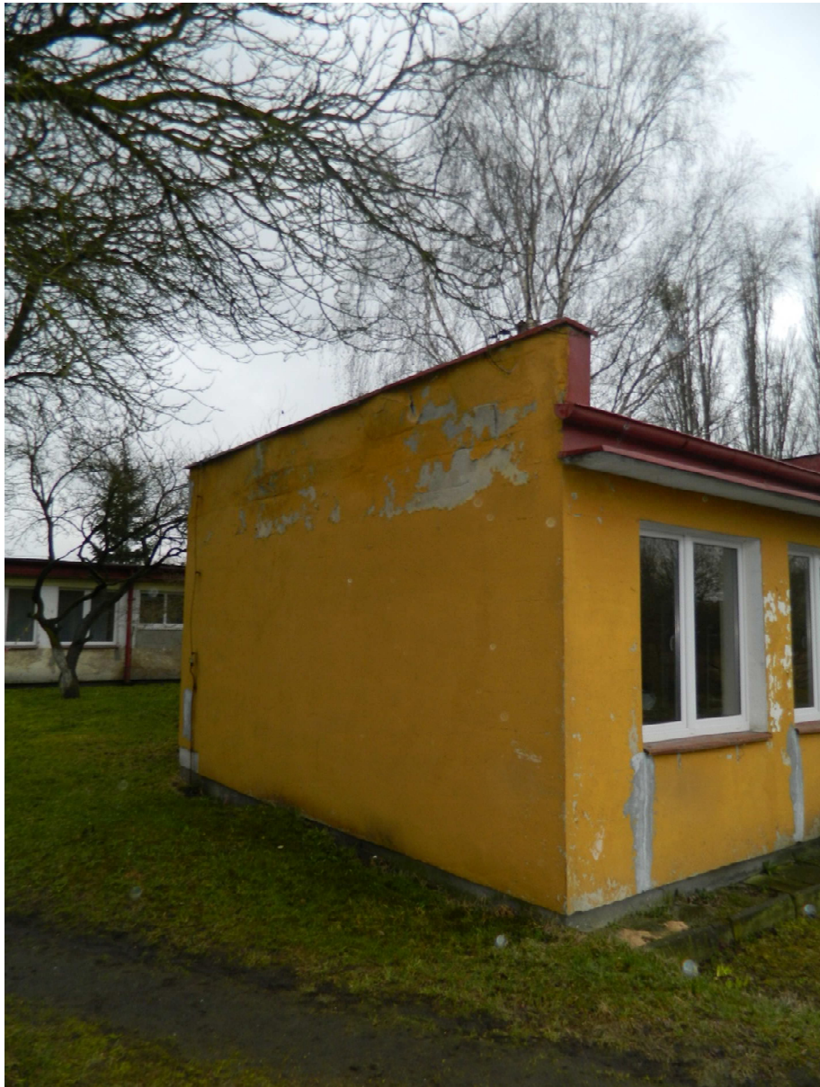
Rysa podłużna wzdłuż attyki – efekt braku dylatacji w konstrukcji dachu
